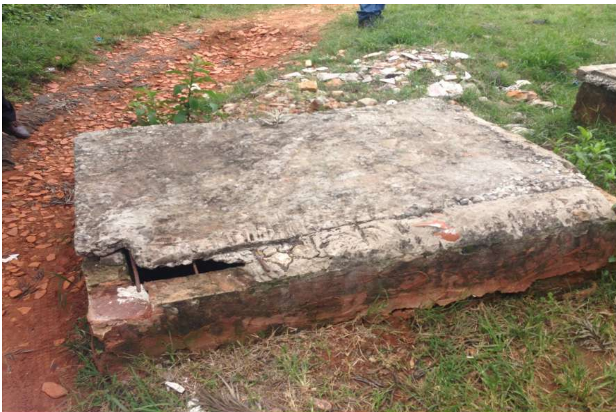
Figura 21. Tapa de la cisterna de agua potable en un establecimiento de salud
